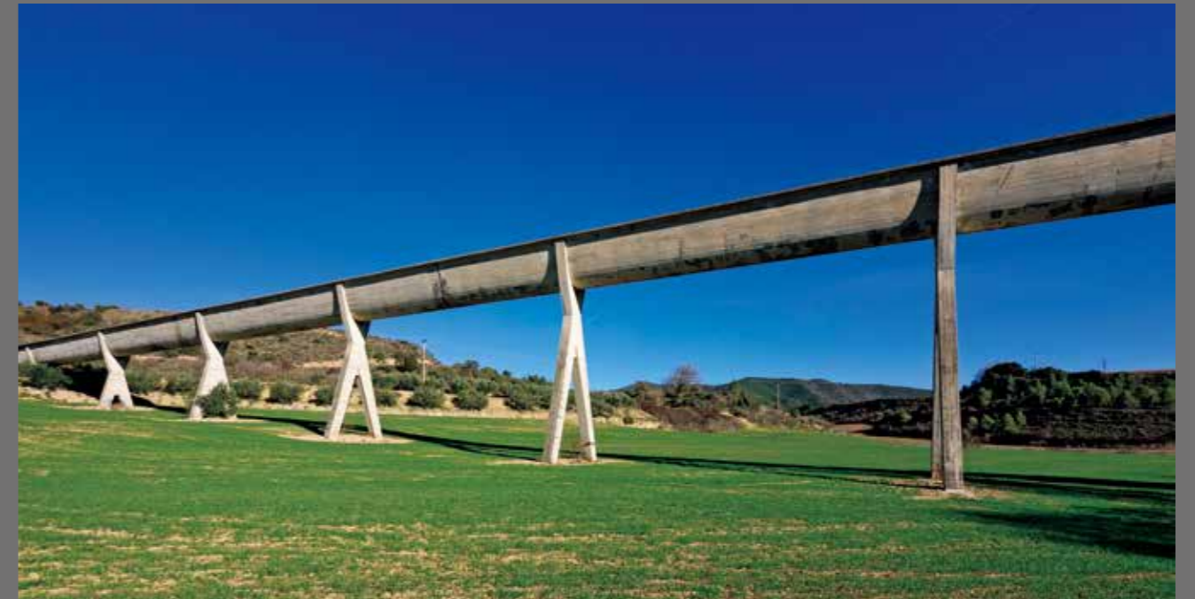
U字断面の水路はひび割れによる水漏れを防ぐため、長手短手の両方向に圧縮応力を入れたプレストレスト・コンクリート製。支柱間の20mと両端10mで1ユニットを構成し、写真中の左右のスパンそれぞれにジョイント部を設けている [写真：八馬 智]
