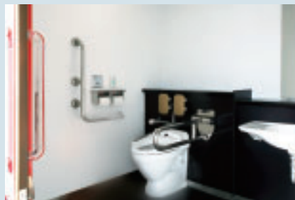
28階多目的トイレ ●INAX使用商品●洋風便器：C-24PRCN、タッチスイッチ：OKC-2B-TU2、シャワートイレ：CW-P22F-TUC、紙巻器：CF-62HS、手すり：KF-920SR50、KF-480SH70、手洗器：L-275FCR、水栓金具：AM-51U (100V)
