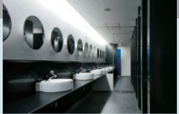
27階女子トイレ ●INAX使用商品●洗面器：GL-543、水栓金具：AM-91 (100V)、電気温水器：EHPN-CA4S1、ハンドドライヤー：KS-520
